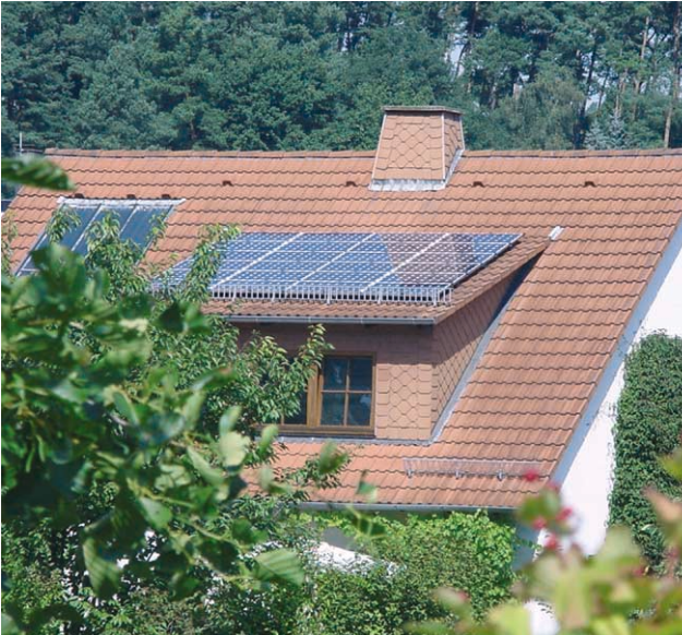
Bild 11 2kW-Photovoltaikanlage auf einer Dachgaube installiert
