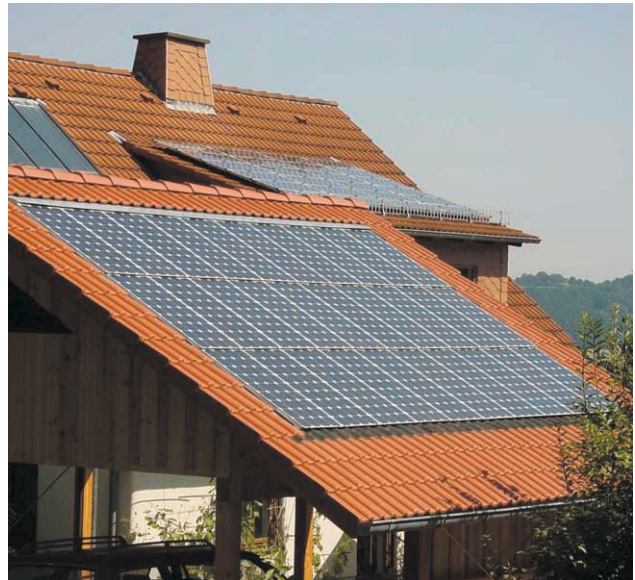
Bild 8 Laminatmodule in das Dach eines Carports integriert
