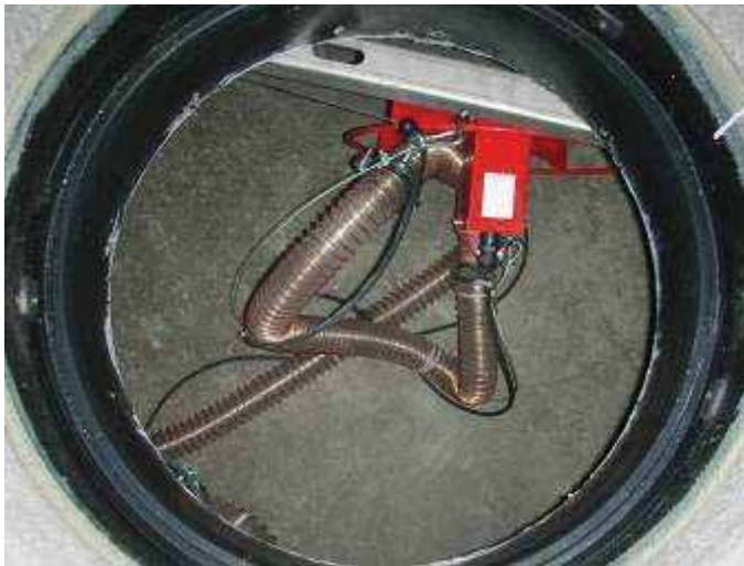
Bild 4 System in Parkposition für Befüllung
