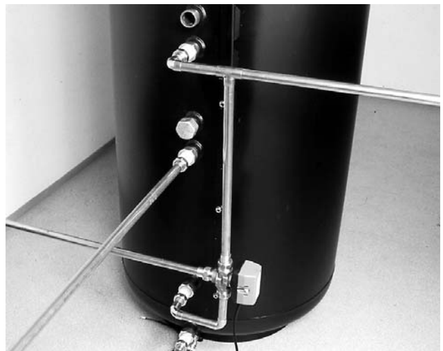
Bild 7 Bei Einbindung der Solaranlage in die Heizungsanlage mit Rücklaufanhebung verwenden Sie bitte den optionalen Umschaltventilsatz (Art.-Nr. 130 100 19).
